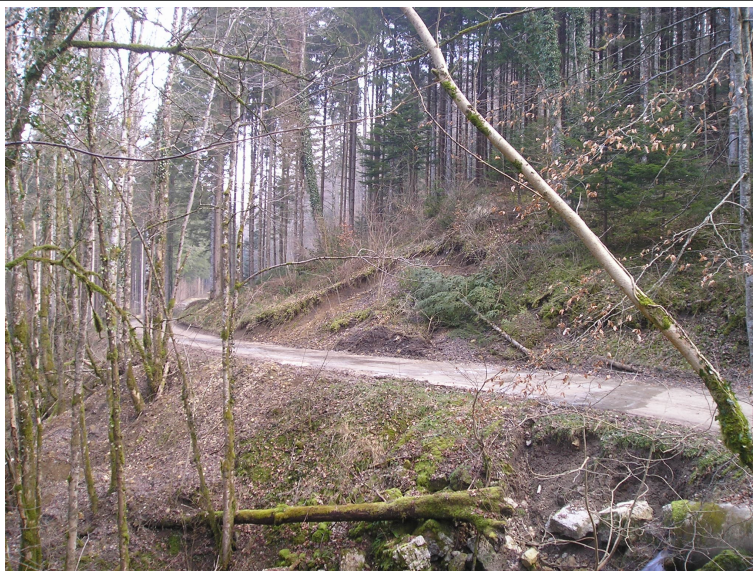
photo n° 5 : glissement de talus dans les marnes le long du chemin d'accès à la Combe de Fleurey.
