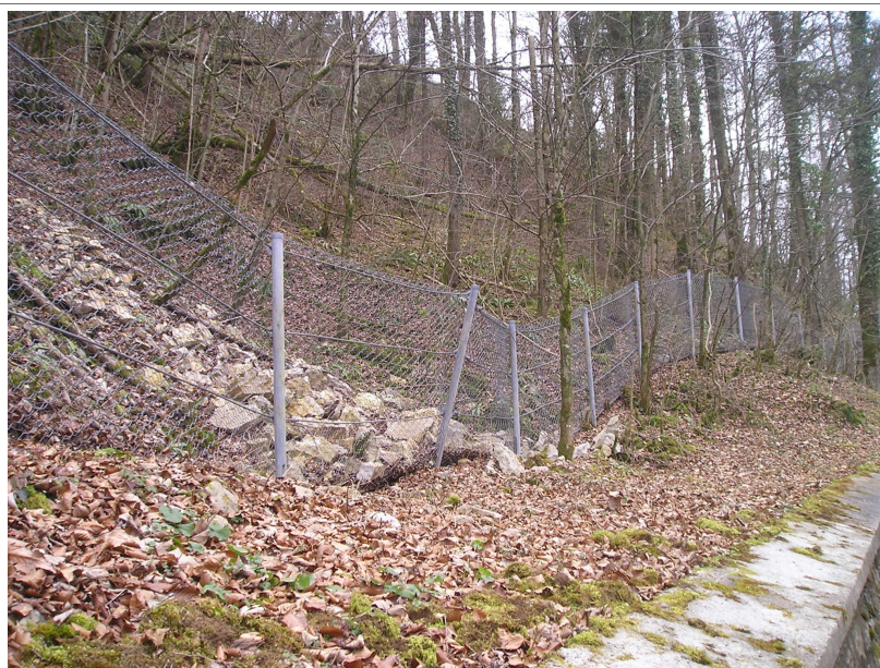
photo n° 4 : éboulis de « dalle nacrée » le long de la RD134.
